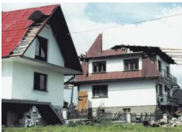
Fot. 3. W dachu widocznym po lewej blacha dachówkopodobna ma poderwane wszystkie połączenia poszczególnych arkuszy. Bardziej jednak ucierpiał dach pokryty blachą arkuszową łączoną na rąbek.
